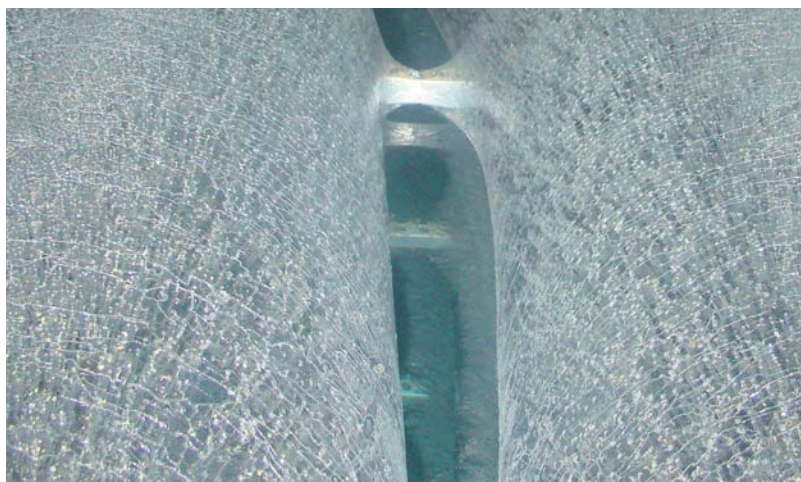
Eisbildung um den Wärmeüberträger im Eisspeicher
